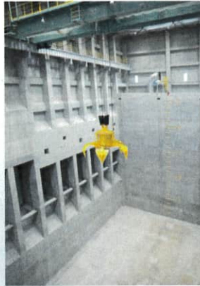
●ごみピット・ごみクレーン ごみピットに貯留されたごみは、ごみクレーンにより攪拌されてから、回転ストーカ炉に投入されます。
