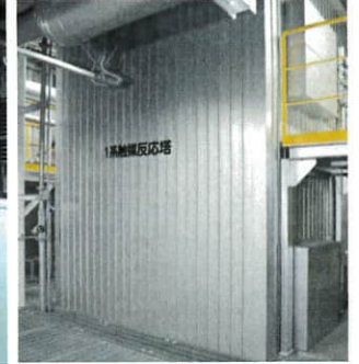
●触媒反応塔 アンモニア触媒の効果で、排ガス中の窒素酸化物、ダイオキシン類を除去します。
