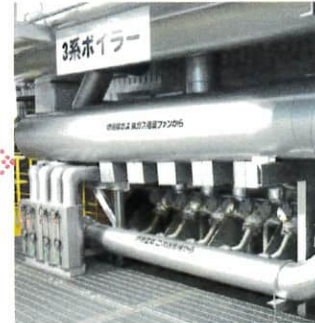
●ボイラ ごみを燃やした熱を利用して、蒸気を生産させます。
