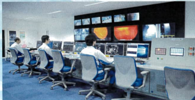
●中央制御室 施設内の機器と設備全体の監視・制御や運転操作をここで集中して行っています。
