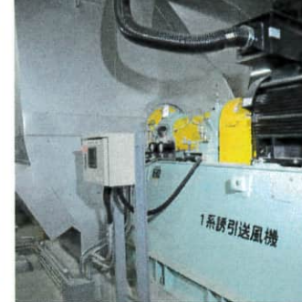
●誘引送風機 排ガスを吸い込んで、煙突に向けて吐き出します。
